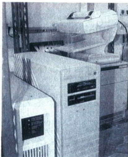
Die Hirne residieren in aller Bescheidenheit. Links neben der Altos-Zentraleinheit das Notstromaggregat. Dahinter der Rechner der Telefonzentrale.
